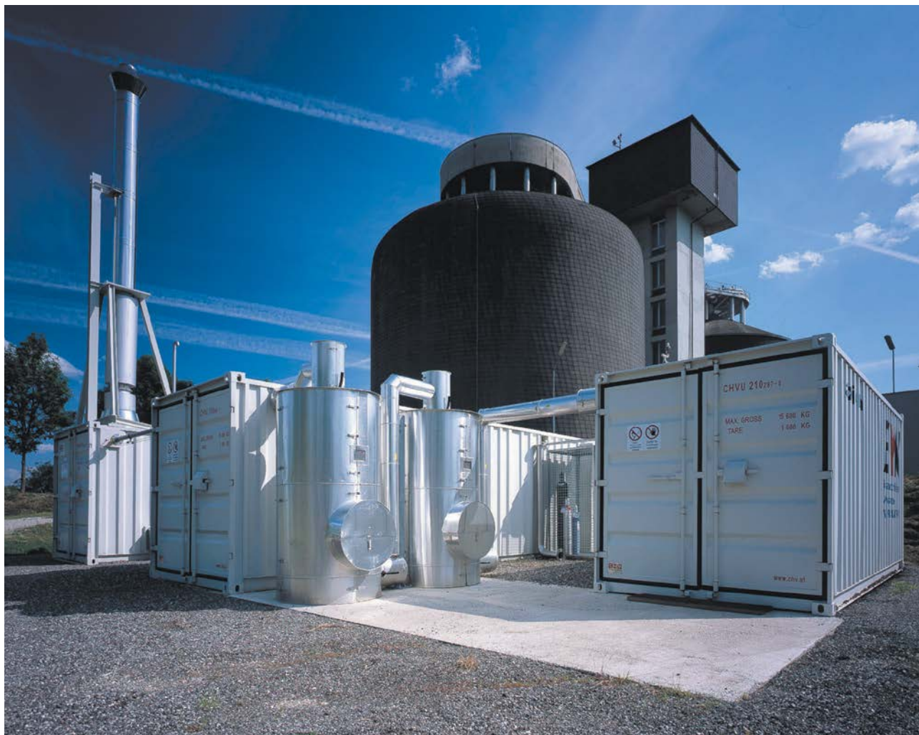
/ Membranowy system oczyszczania biogazu – Austria
